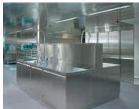
Zone Vorreinigung Zentralsterilisation.
